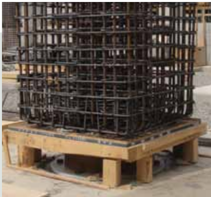
Sobre el aislador elastomérico se monta la enfierradura del capitel, del cual nacen los pilares.
