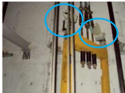
Daños en guidores y lubricadores de contrapeso
