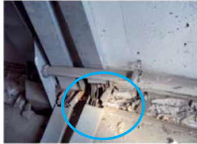
Daños en sistemas eléctricos
