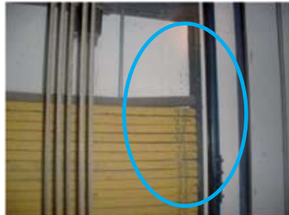
Desprendimiento de elementos del contrapeso que no contaban con sistemas antisísmicos
