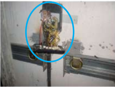
Caja eléctrica del shaft quedó colgando
