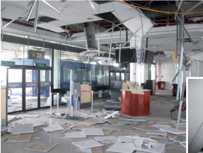
Daños en el Aeropuerto Internacional Arturo Merino Benítez por caída de equipos de clima y otras instalaciones.
