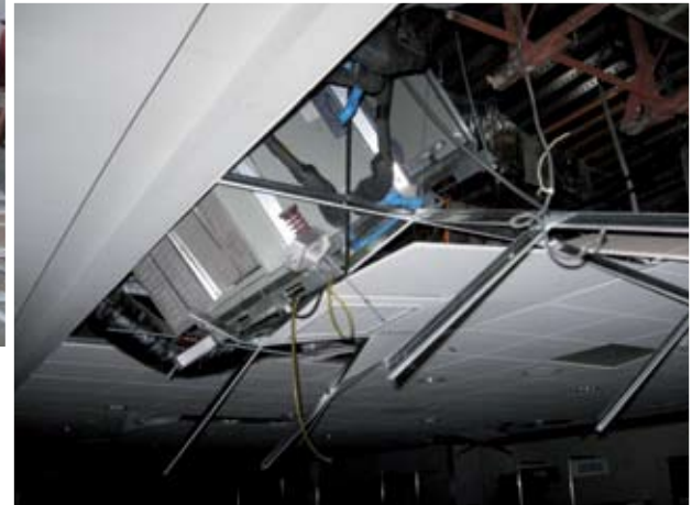
Desprendimiento equipo de aire acondicionado dañando la instalación de cielo falso.
