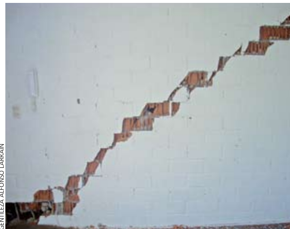
Una de las fallas recurrentes observadas en este terremoto, en muros de albañilería, fueron las grietas de corte.
