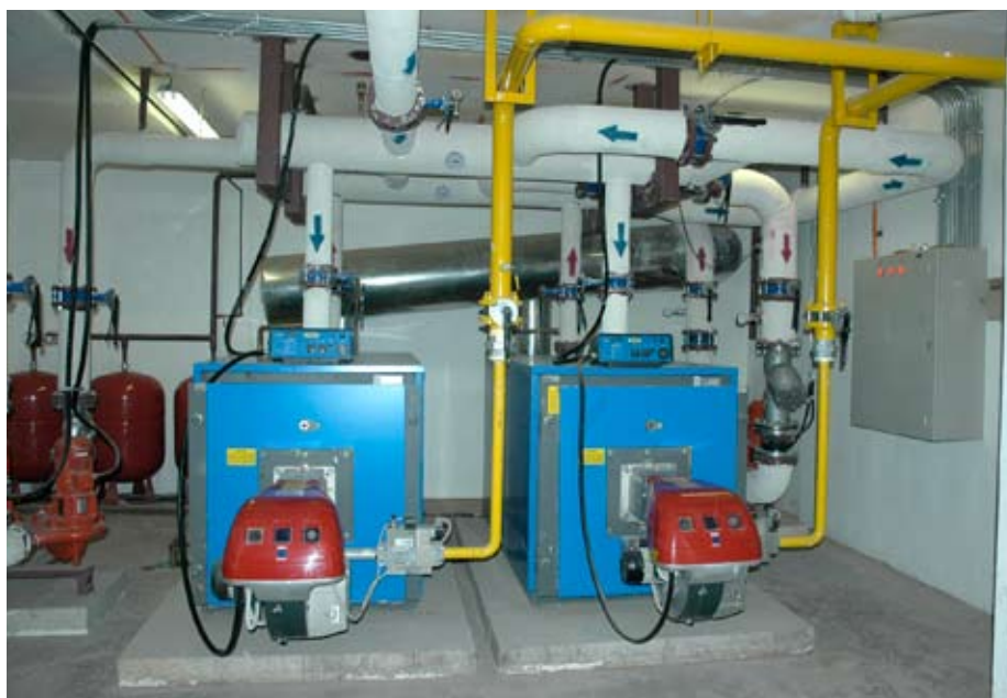
Sala de caldera en obra de constructora Moller y Pérez Cotapos.
