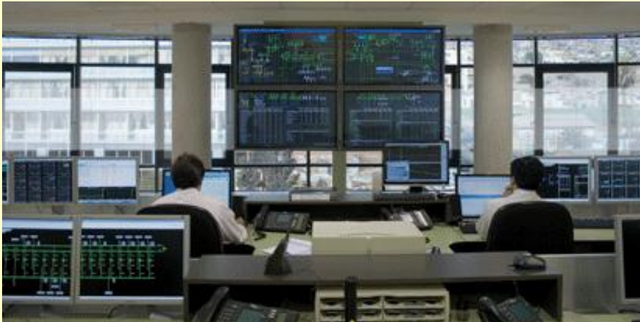
Centro de Control del CDEC-SING
