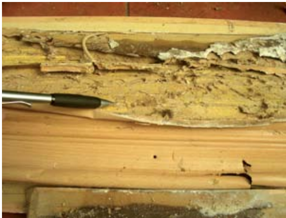
Daños ocasionados por la termita subterránea en guardapolvos y pisos flotantes foto-laminados.
